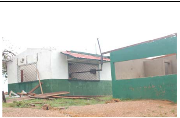
Caseta de Planta Eléctrica de Emergencia
