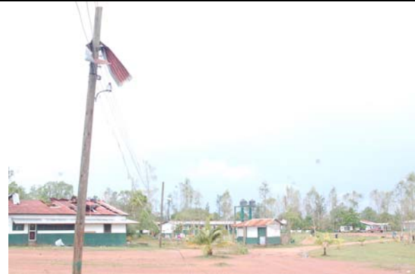
Tendido Eléctrico dentro del Recinto
